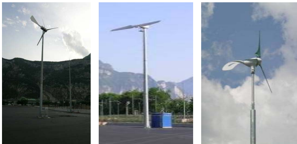
Figura 1 – Le turbine installate presso il Campo Eolico Sperimentale di Trento: JIMP20 (a sinistra), GAIA WIND (al centro) e Airdolphin (a destra).
